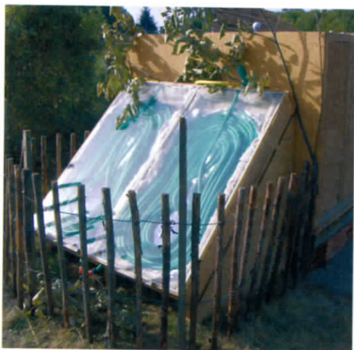
► Douches solaires de l'Écocentre du Périgord avec des capteurs à tuyau d'arrosage.
